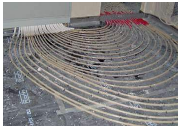
Die Fußbodenheizung für Kellerräume, Ober- und Dachgeschoss wird über den Schichtenspeicher versorgt. Insgesamt wurden 7500 m Fußbodenheizung auf ca. 1169 m 2 Fläche verlegt
